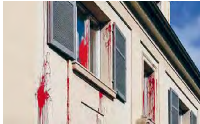
4 Farbangriff auf das Amtsgericht Waiblingen
