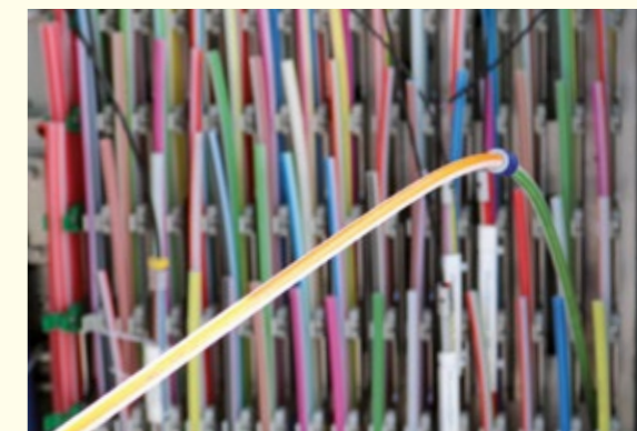
Blick in den Verteilerkasten
